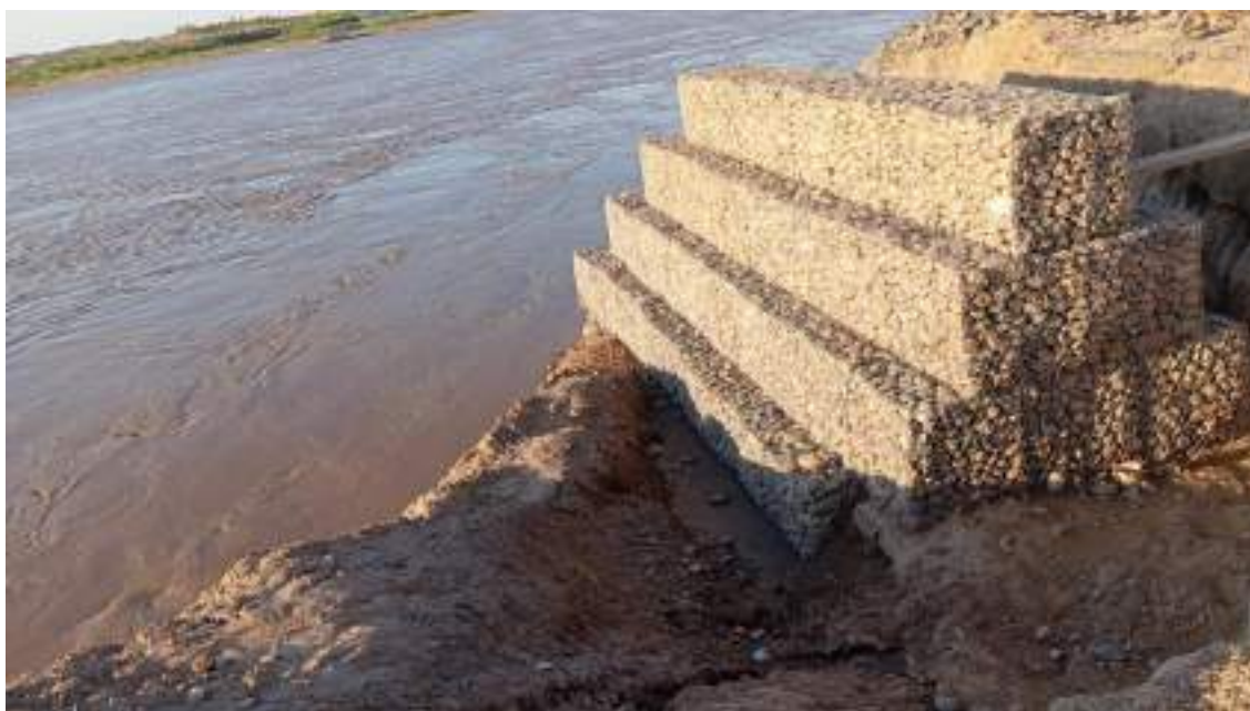
Imagen 15 - Imagen del gavión de Protección en el Barrio Isla Grande D2
