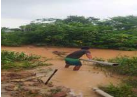
FIGURA 13: TRABAJOS DE RESTITUCIÓN DEL SISTEMA DE ADUCCIÓN DE LA TOMA CAMUY, PROVOCADO POR LAS INTENSAS LLUVIAS.
