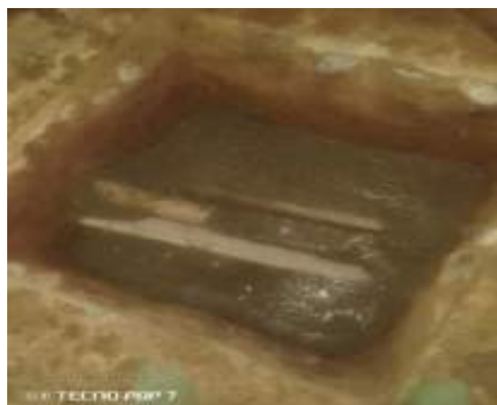
Figura 21: CAMARA DE INSPECCION PRELIMINAR REDDE ALCANTARILLADO SANITARIO U.E. GUALBERTO VILLARROEL
